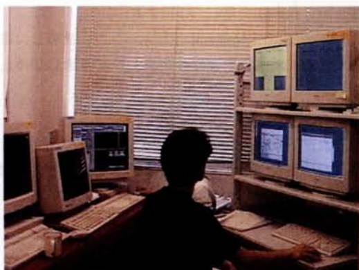
図 17 統合管理システム設置状況
